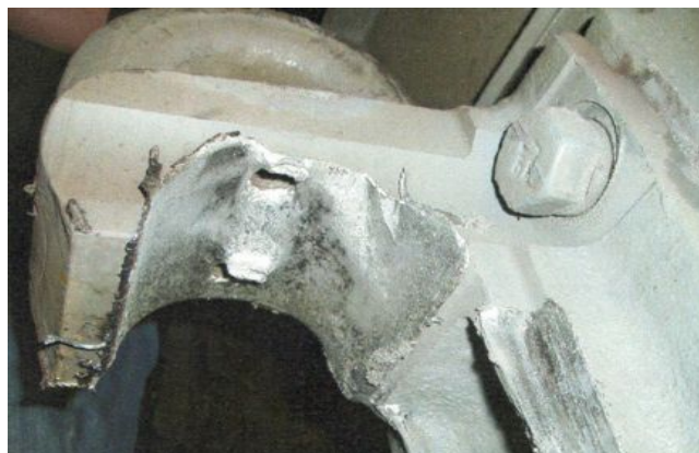
Износ опорной части кронштейна двигателя противоположного корпусу редуктора
