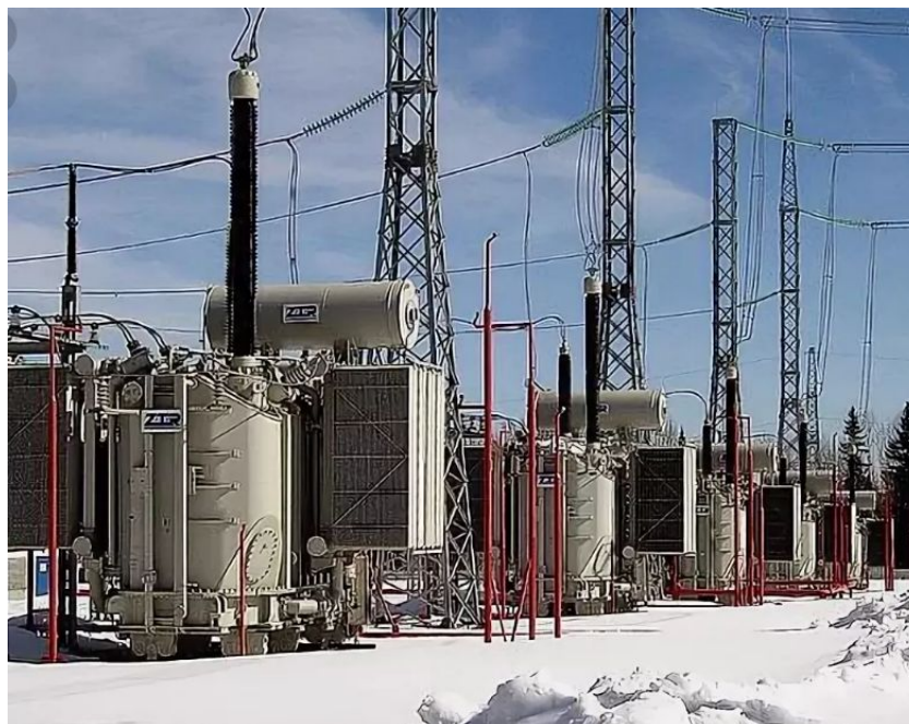
Группа автотрансформаторов 500 кВ
