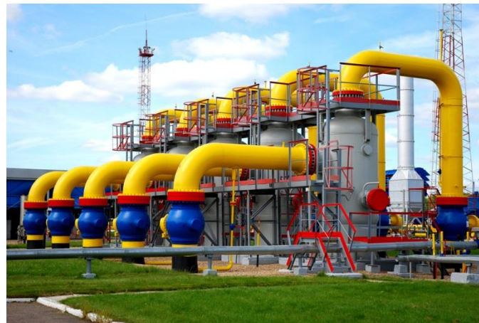
Линейное производственное управление магистральными газопроводами.
