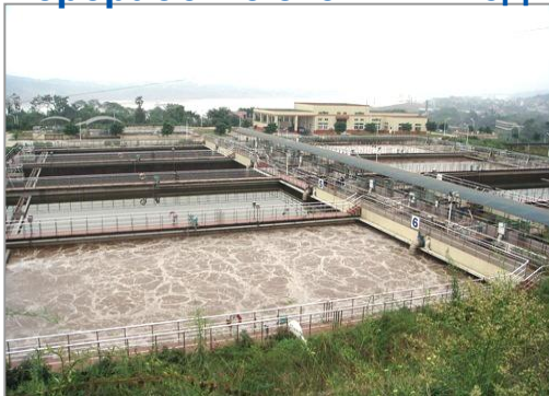
Dadukou Sewage Treatment Plant станция в Дадукоу по переработке сточных вод
