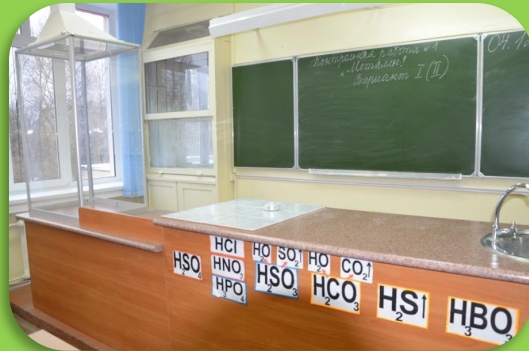
Вытяжной шкаф в кабинете химии
