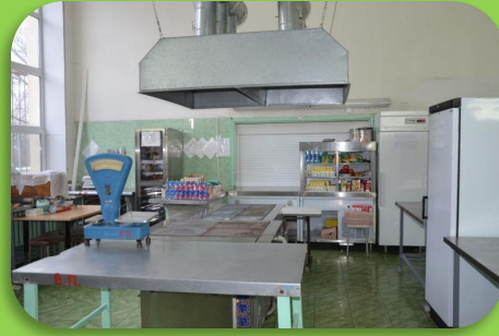
Вентиляционная вытяжка, холодильные шкафы, шкаф для хлеба
