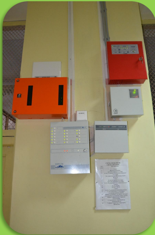
Кнопка пожарной сигнализации
