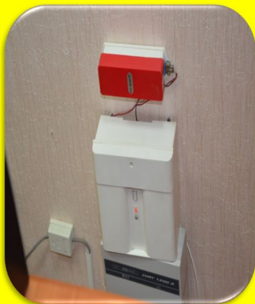
Кнопка тревожной сигнализации с выводом на ОВО МВД
