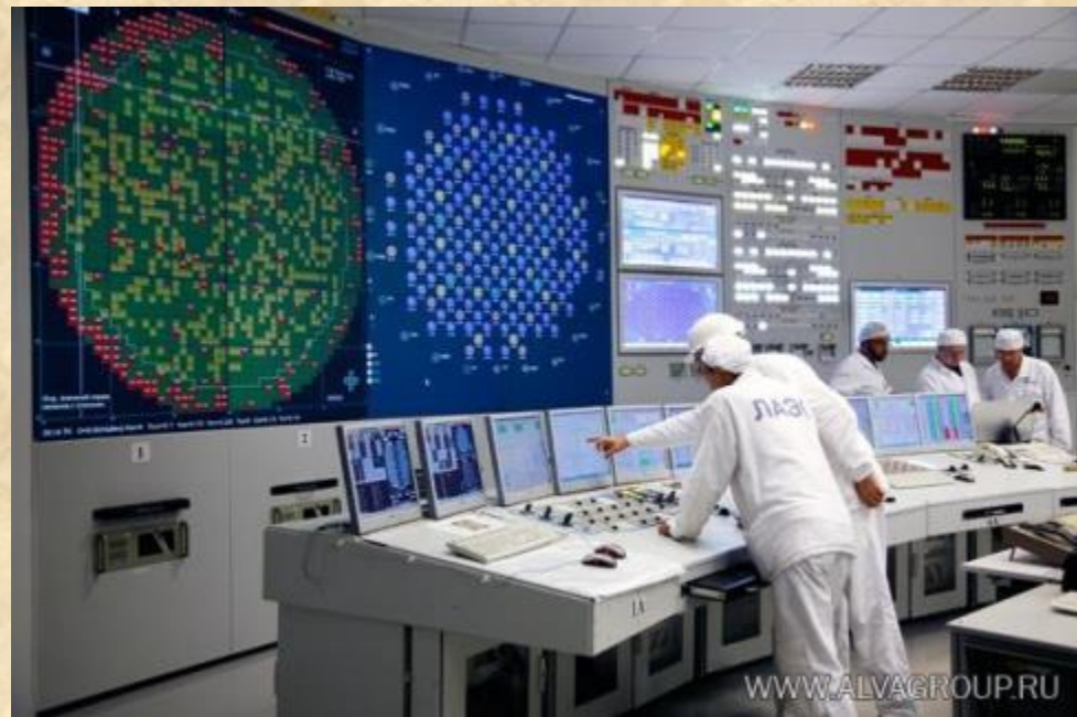
Ленинградская АЭС. Блочный щит управления
