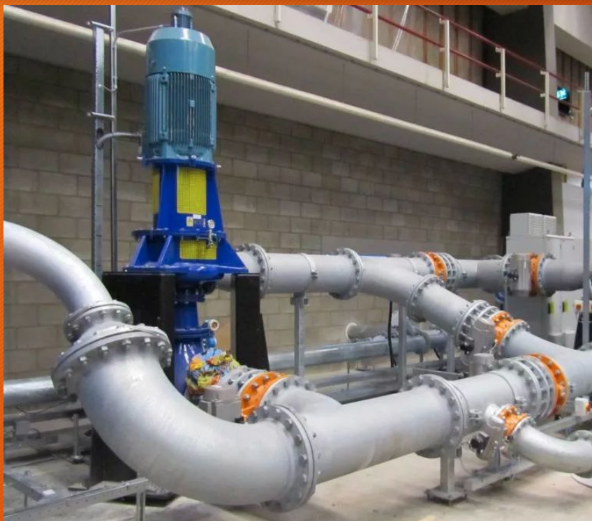
Гидросистемы - транспортируют твердые смеси с водой
