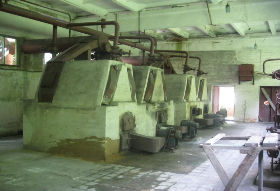
Загальний вигляд котельні
