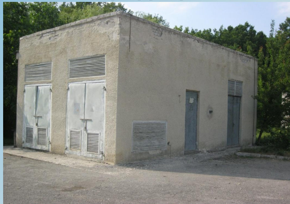
Загальний вигляд трансформаторної підстанції
