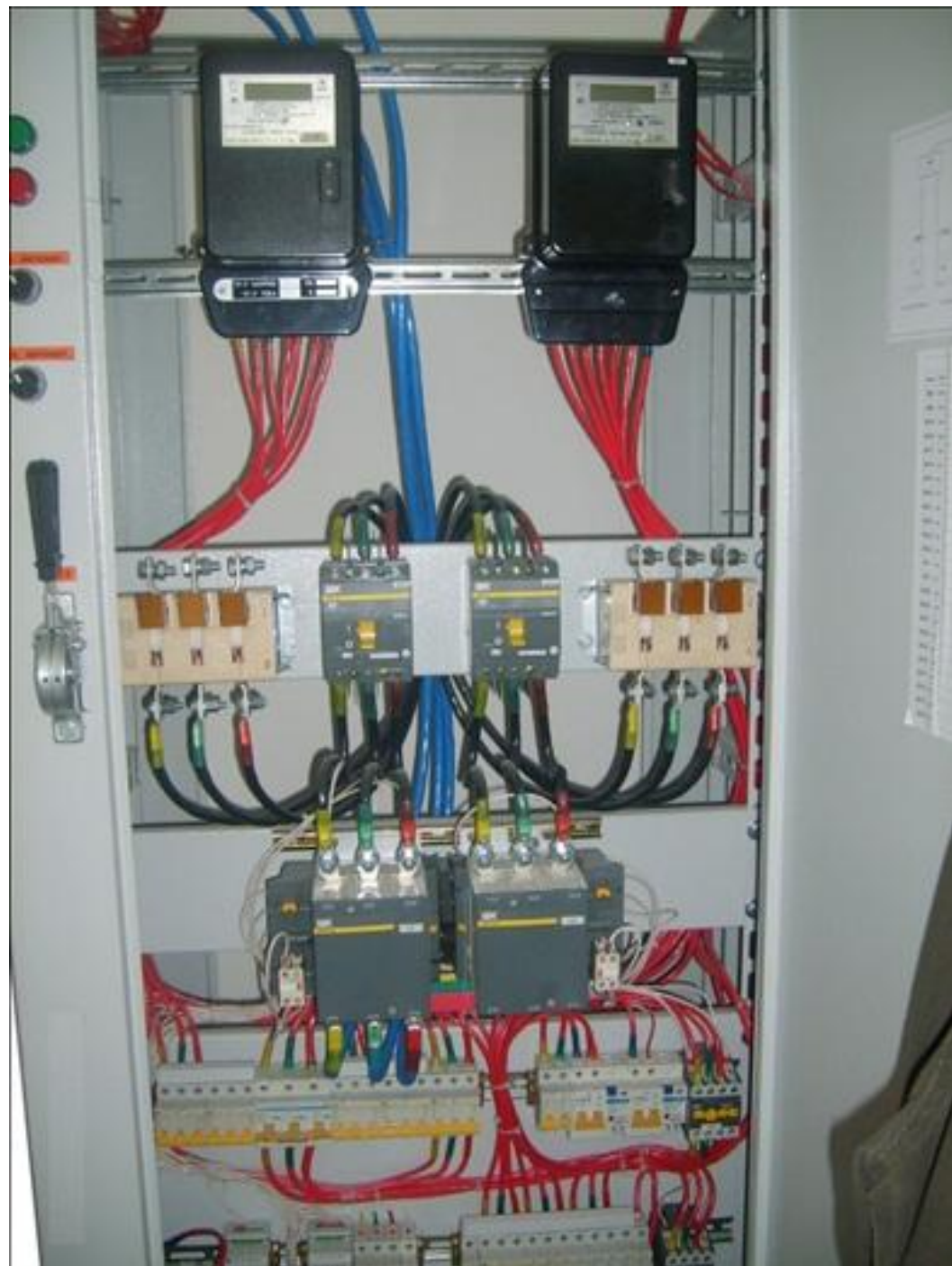
Главные распределительные щиты
