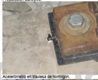
Acelerómetro en traviesa de hormigón.
