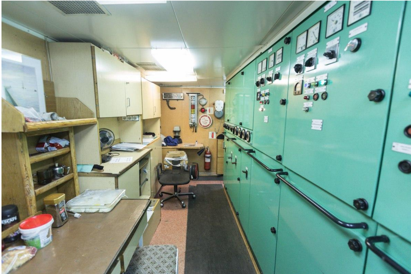
Главный судовой распределительный щит
