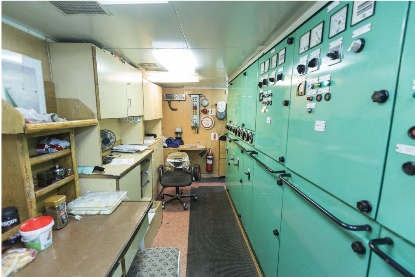
Главный судовой распределительный щит
