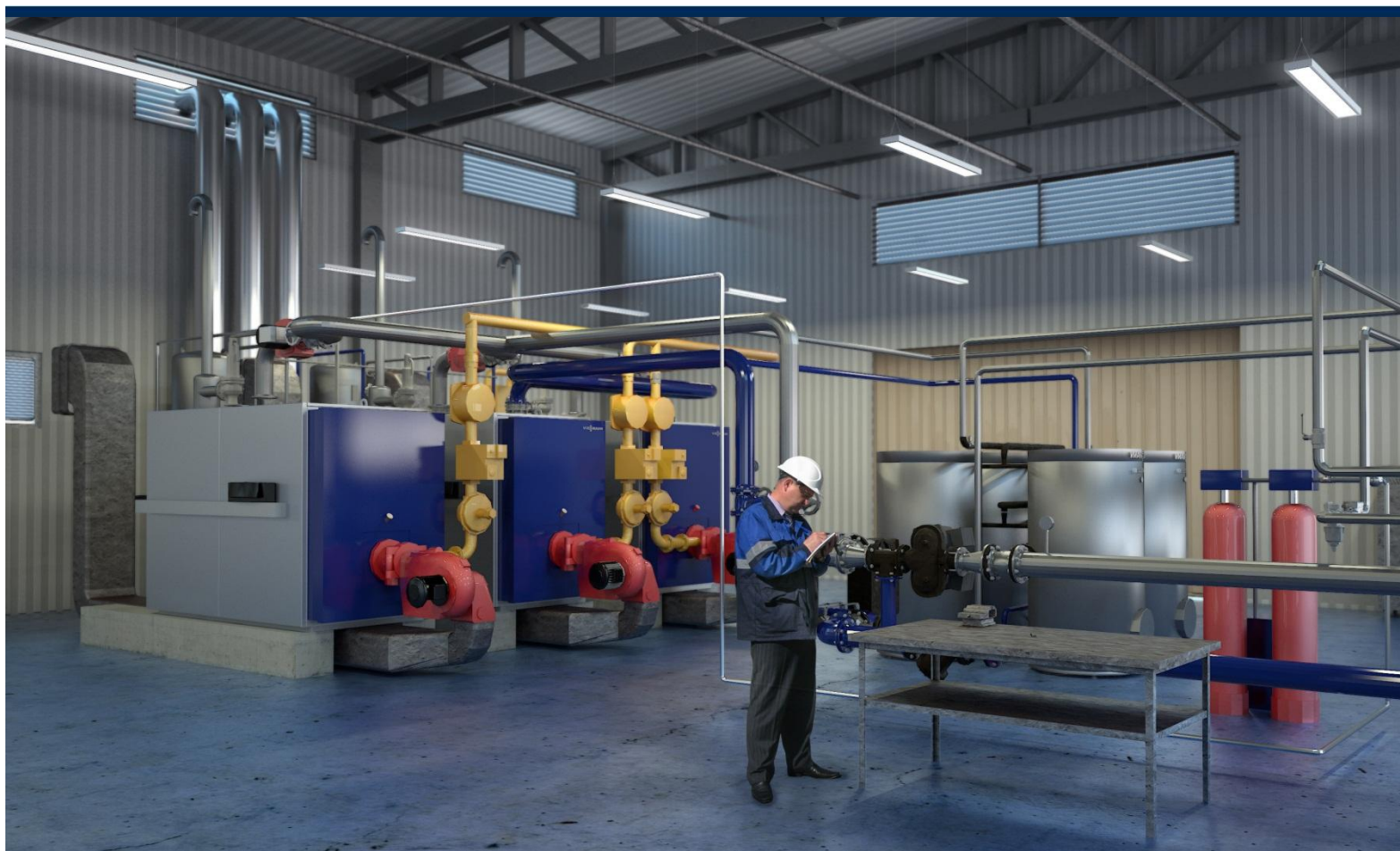
Котельная. Общий вид.
