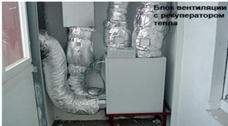
Рекуператоры в лоджии
