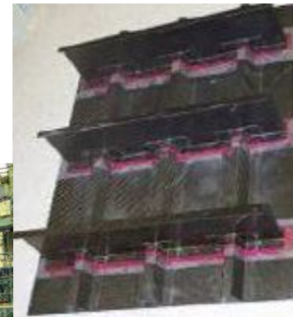
Панели теплообменных аппаратов
