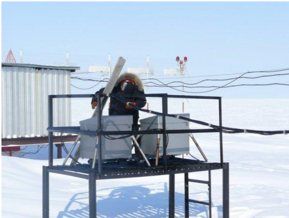
Проверка РВО-2м (Аэропорт Ямбург)
