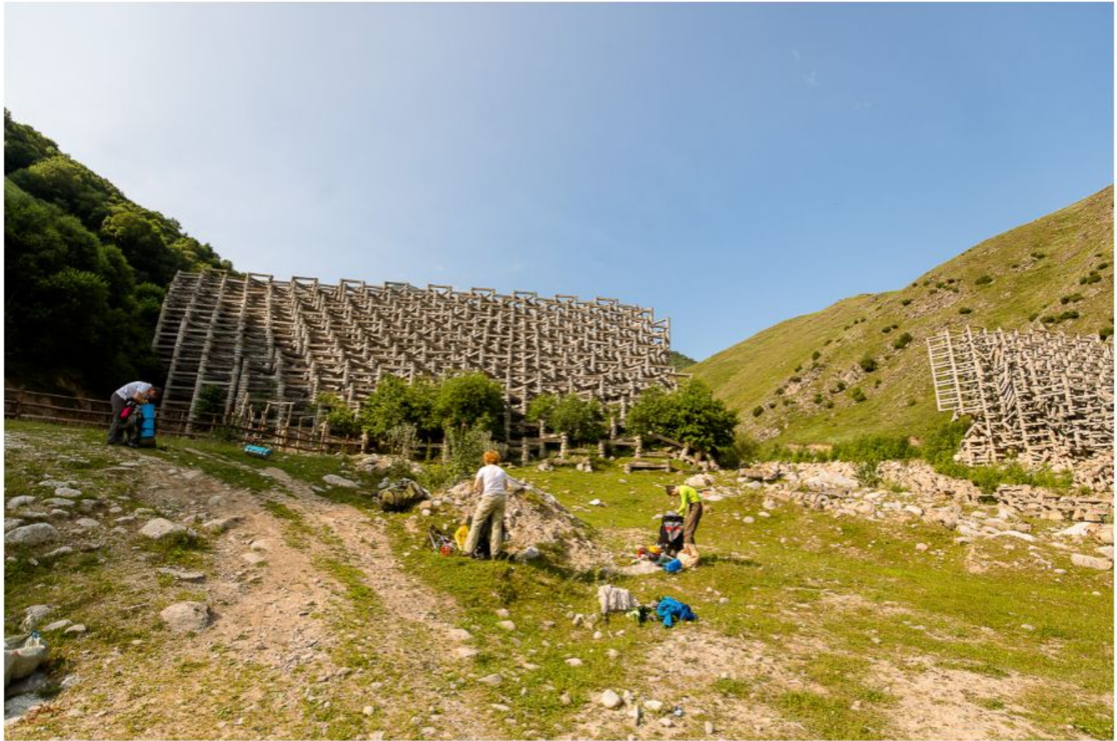
Фото 1. Разрушенная противоселевая дамба на р.Герхожансу
