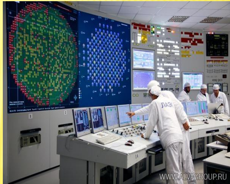
Ленинградская АЭС. Блочный щит управления
