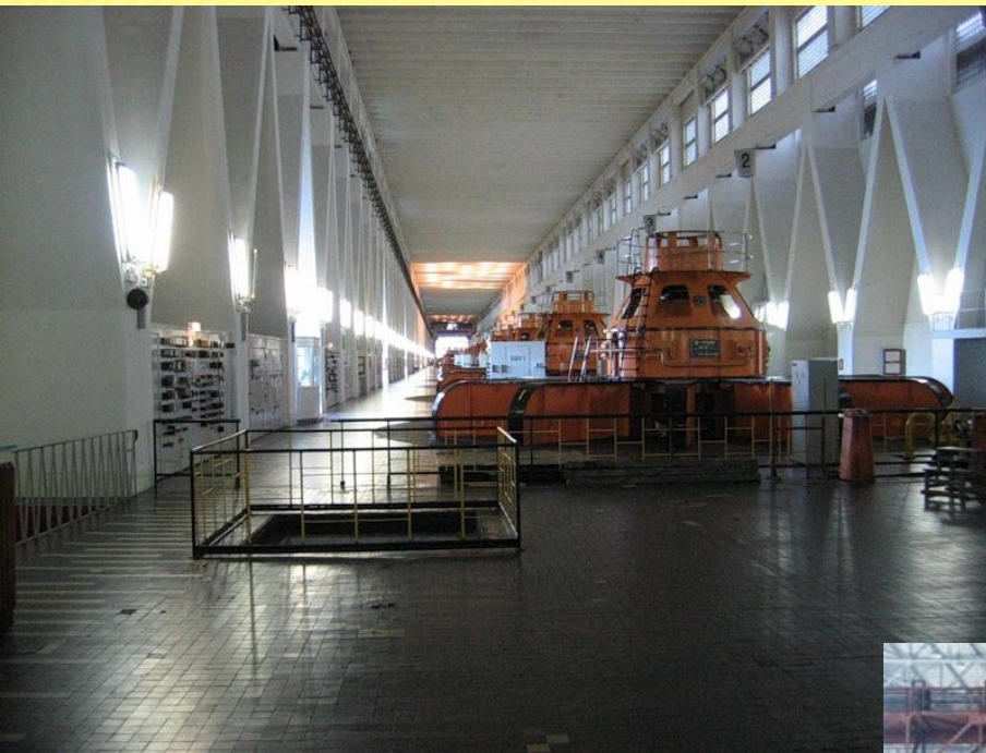
Машинный зал Братской ГЭС
