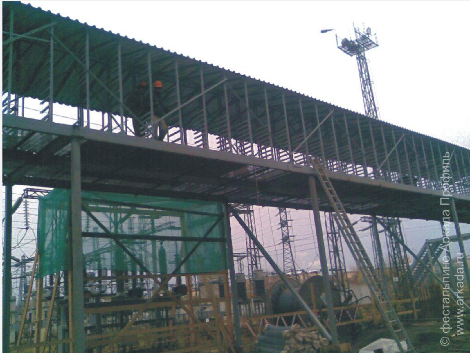
ТЭЦ-14 (Первомайской). Кабельная галерея открытого типа Санкт-Петербург, Дорога на Турухтанные острова
