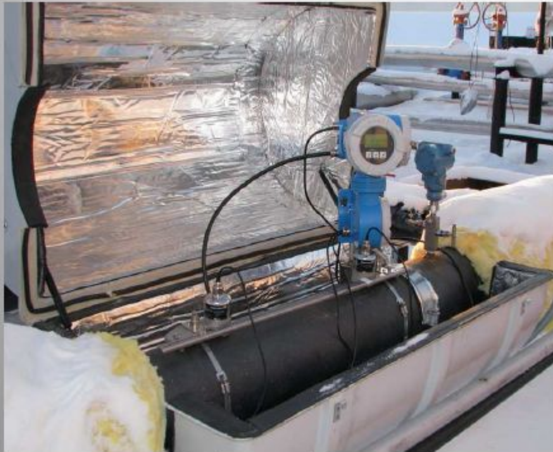
Измерительные приборы на нефтепроводе. Установлены в обогреваемом термошкафу
