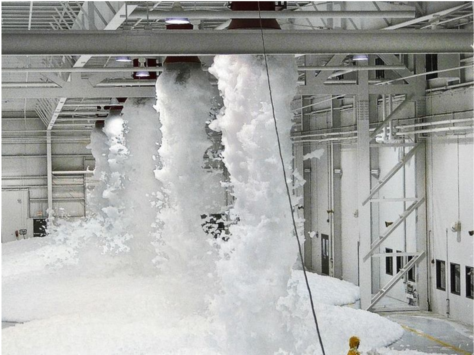
Дренчерная система тушения пожара пенным составом
