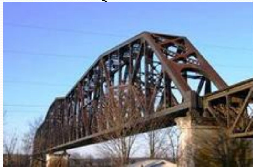
Мост, поврежденный коррозией.
