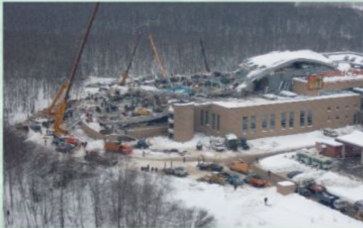
Последствия обрушения аквапарка «Трансвааль парк». г. Москва.
