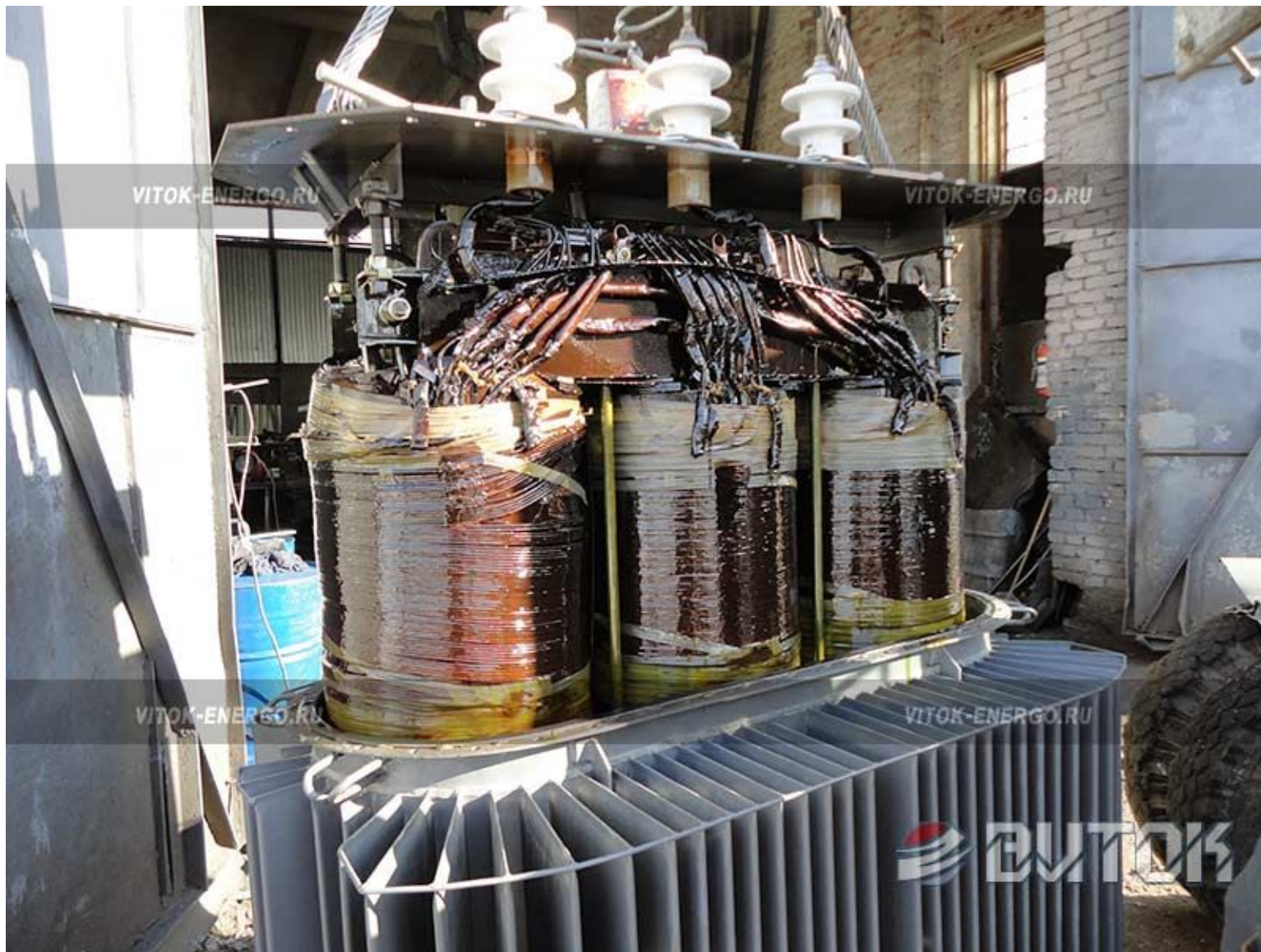
Состояние активной части трансформатора ТМГ 630 кВА после КЗ
