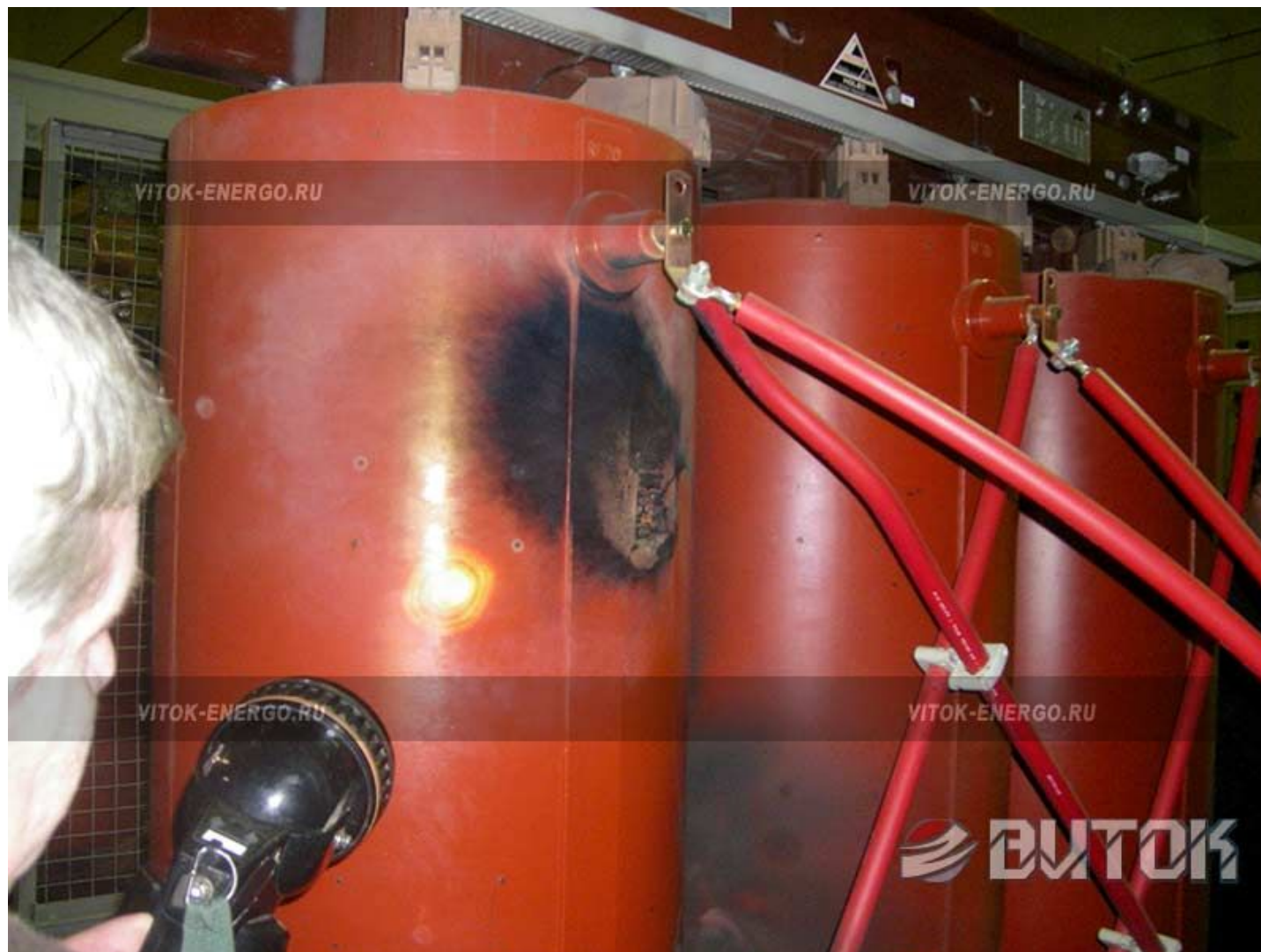
Витковое замыкание, пробой изоляции у сухого трансформатора ТСГЛ 2500 кВА
