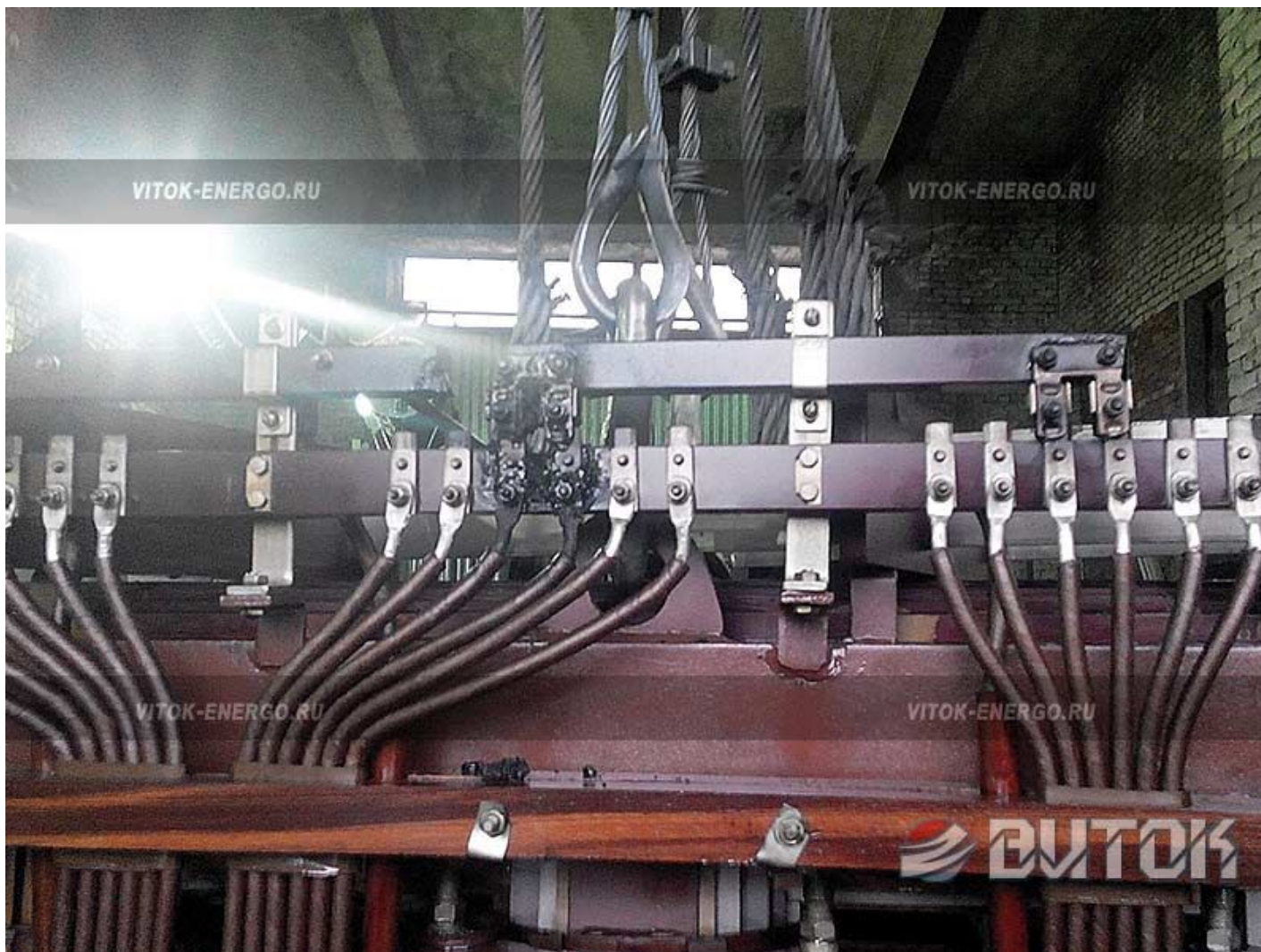
Сгоревший переключатель ПБВ на трансформаторе ТМЗ 1000 кВА
