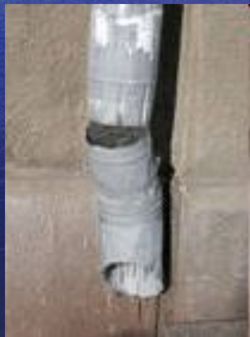
Водосточная труба, разорванная льдом
