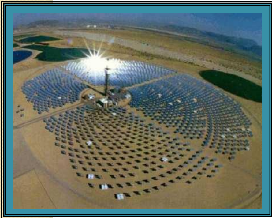
Солнечная электростанция (СЭС)
