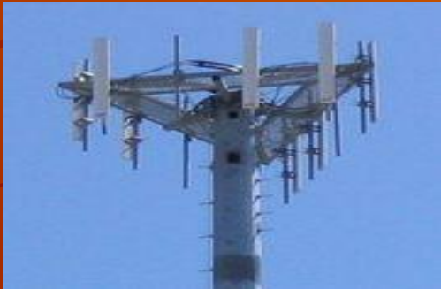
Базовая станция на мачте
