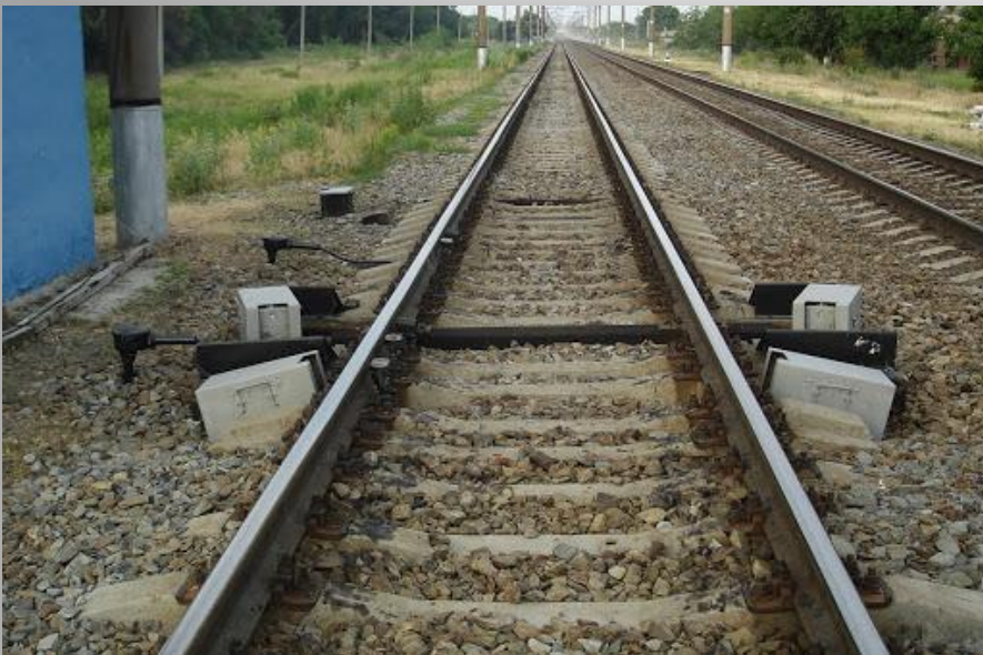
Внешний вид нижнего строения ПОНАБ на ЖД полотне.
