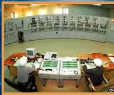
Центр управления АЭС
