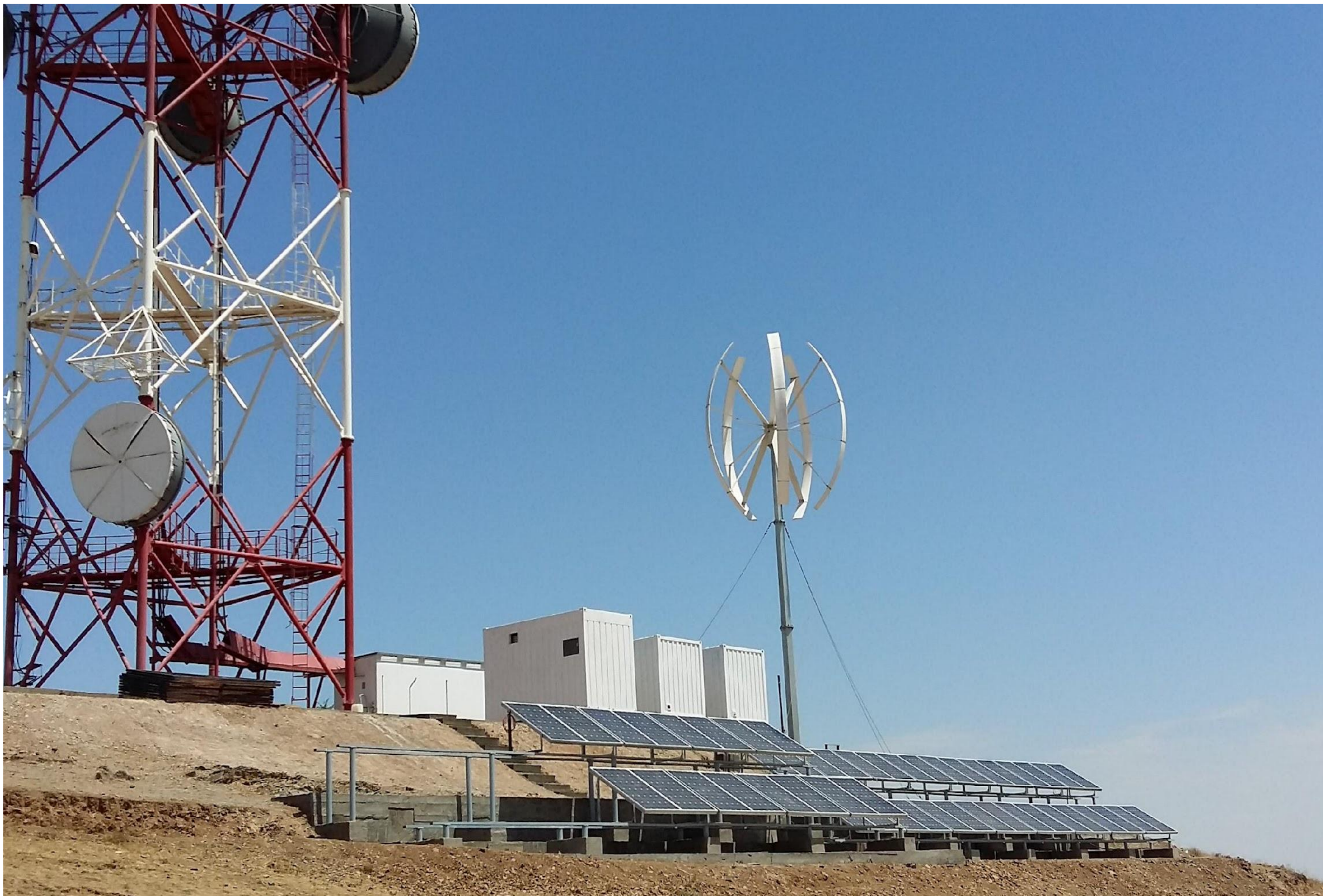
Рис. 6. Автономная солнечно-ветро-дизельная электростанция на объекте «Замбар».
