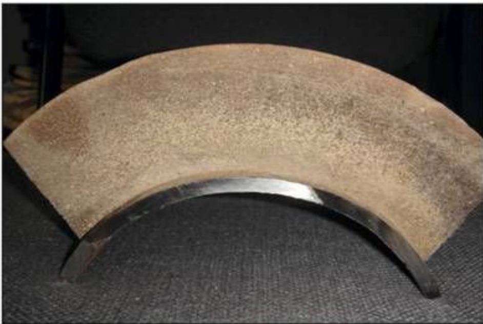
Рис. 1. Образец теплопровода в ППМ изоляции, находившийся в эксплуатации 21 год.
