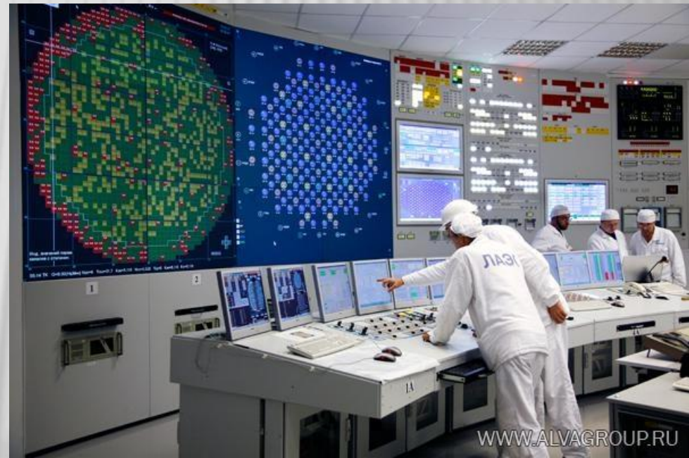
Ленинградская АЭС. Блочный щит управления
