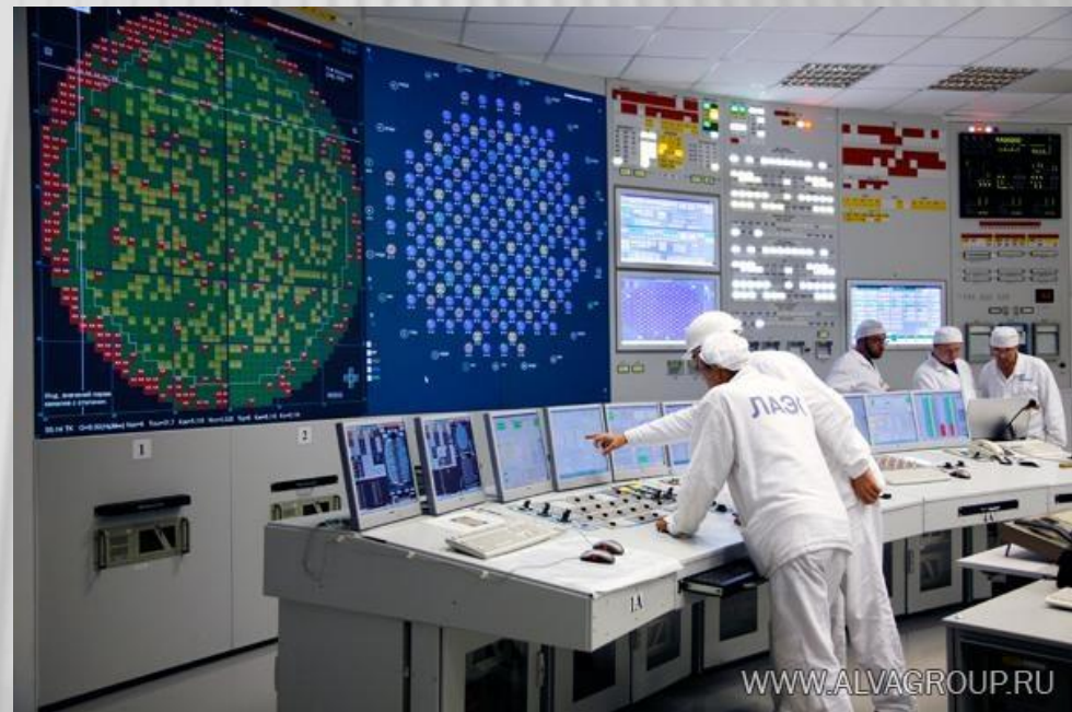
Ленинградская АЭС. Блочный щит управления
