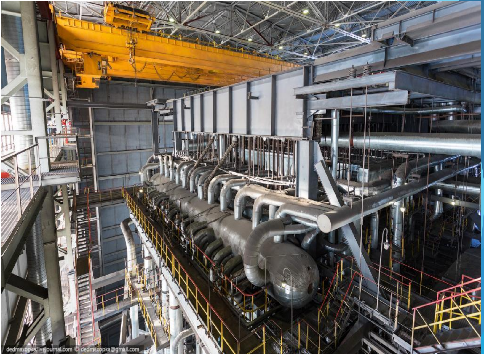
Рис. Барабан котла, вид сверху
