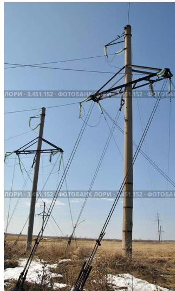
Опоры с оттяжками
