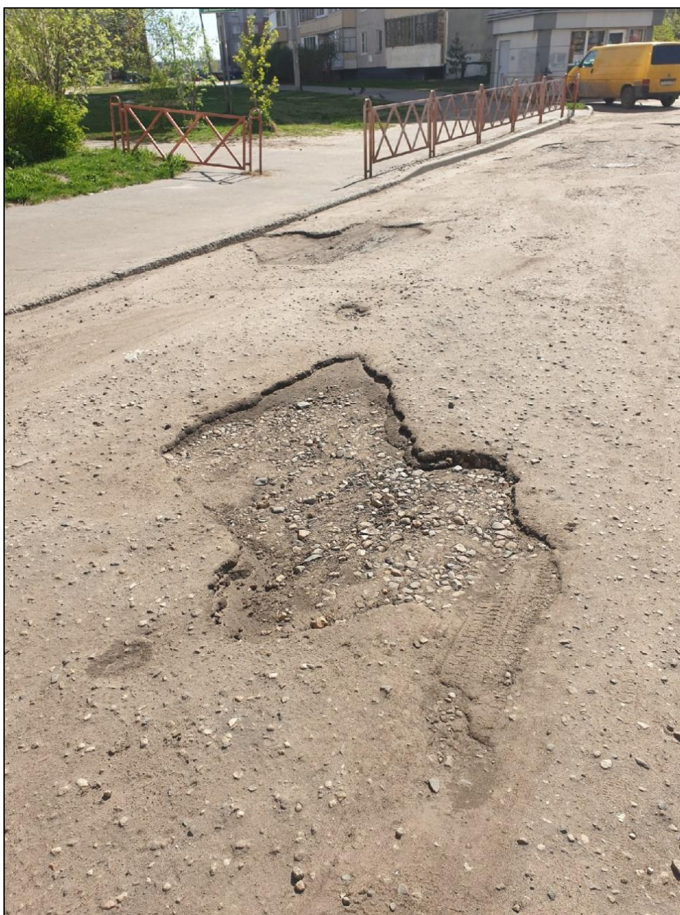
Разрушение асфальтового покрытия
