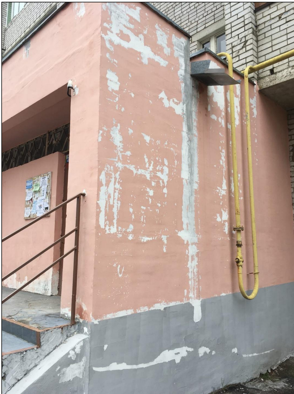
Не окрашено крыльцо после реставрации трещины
