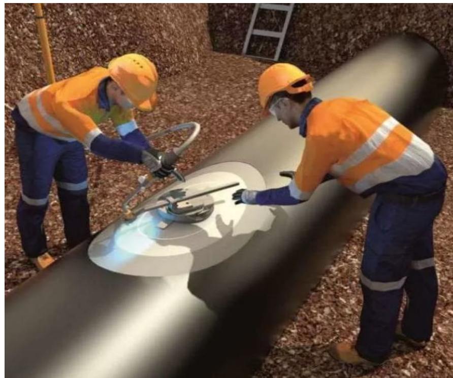
Разметка под вырезку эллиптического отверстия на дефектном участке под ремонт «вваркой заплата» или приваркой патрубков
