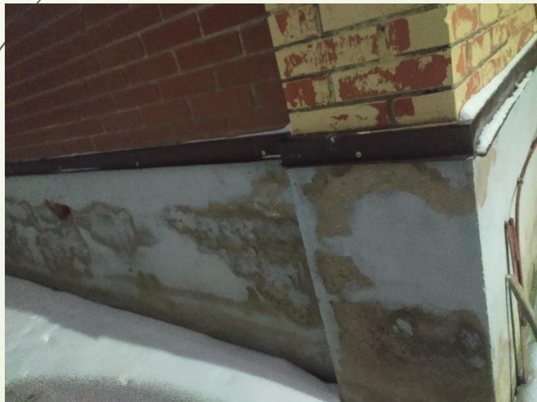
Шелушение краски на цоколе
