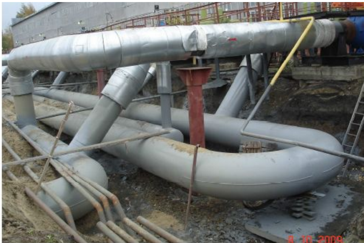
Рис.2.7. Подземные кольцевые коллекторы КК2 и КК3
