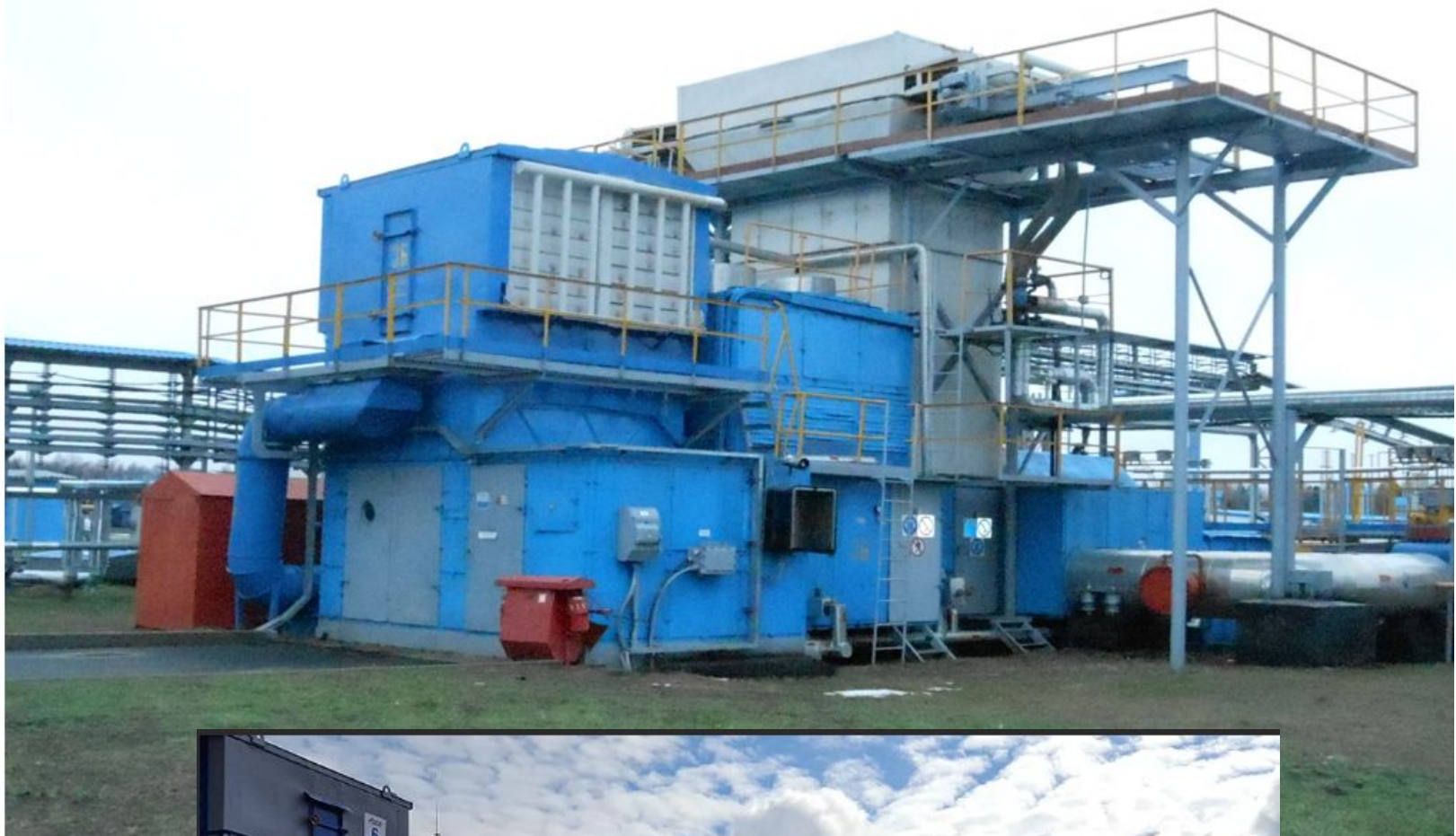
Фото ГПА-Ц-6,3 на компрессорной станции
