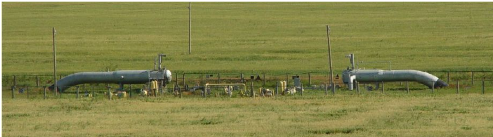
Рис.2.3. Узел подключения КС к магистральному газопроводу: видны камеры запуска и приема очистных и диагностических поршней
