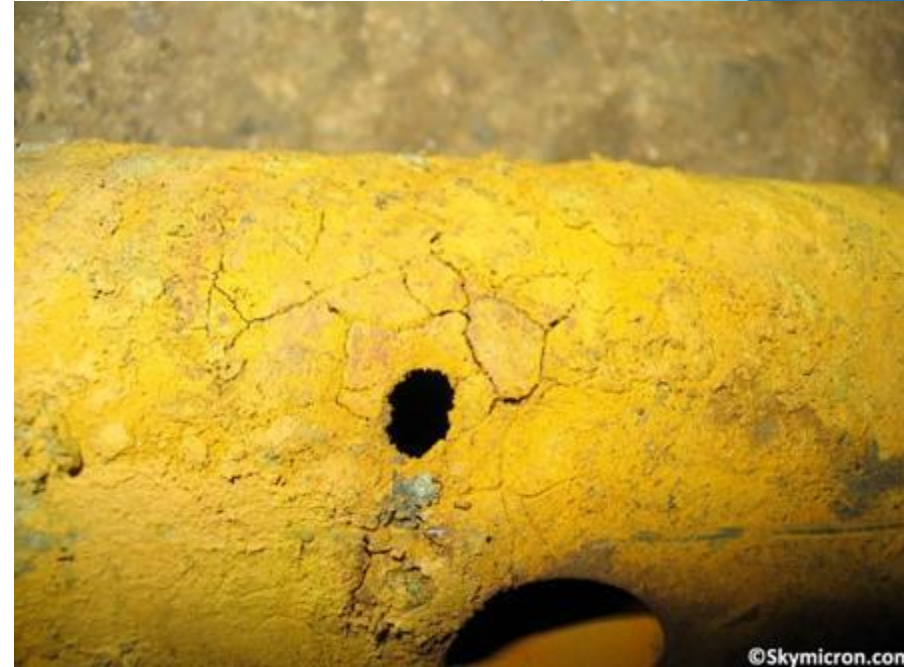
Рис. 7 Результат межкристаллитной коррозии
