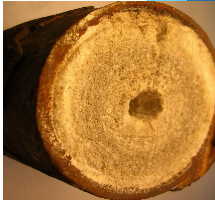
Рис. 1 Накипь в теплообменниках
