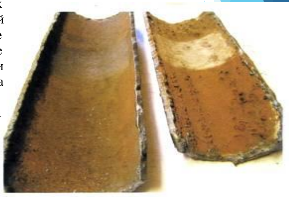
Рис. 4 Внешний вид гальванокоррозии
