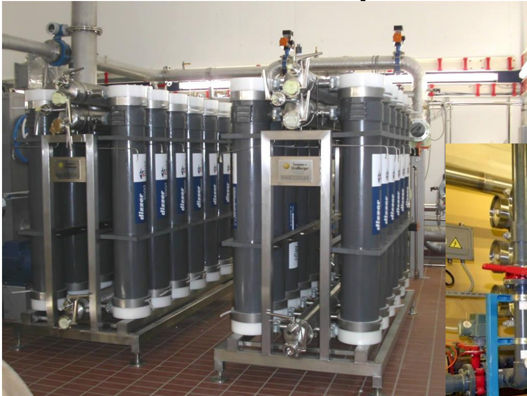
Установка УФ в работе
