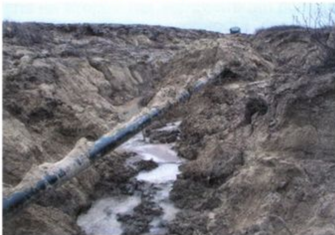
Размыв грунтов при подземной растеплении прокладке газопровода
