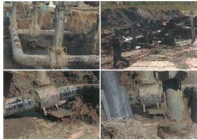
Деформации кранового узла от ММП при подземной прокладке
