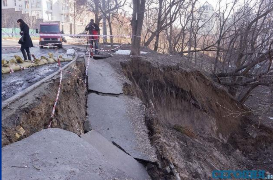
Оползни в г.Киев, апрель 2013 г.
