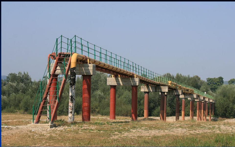
Участок нефтепровода «Дружба» над рекой Стрый (Львовская область)
