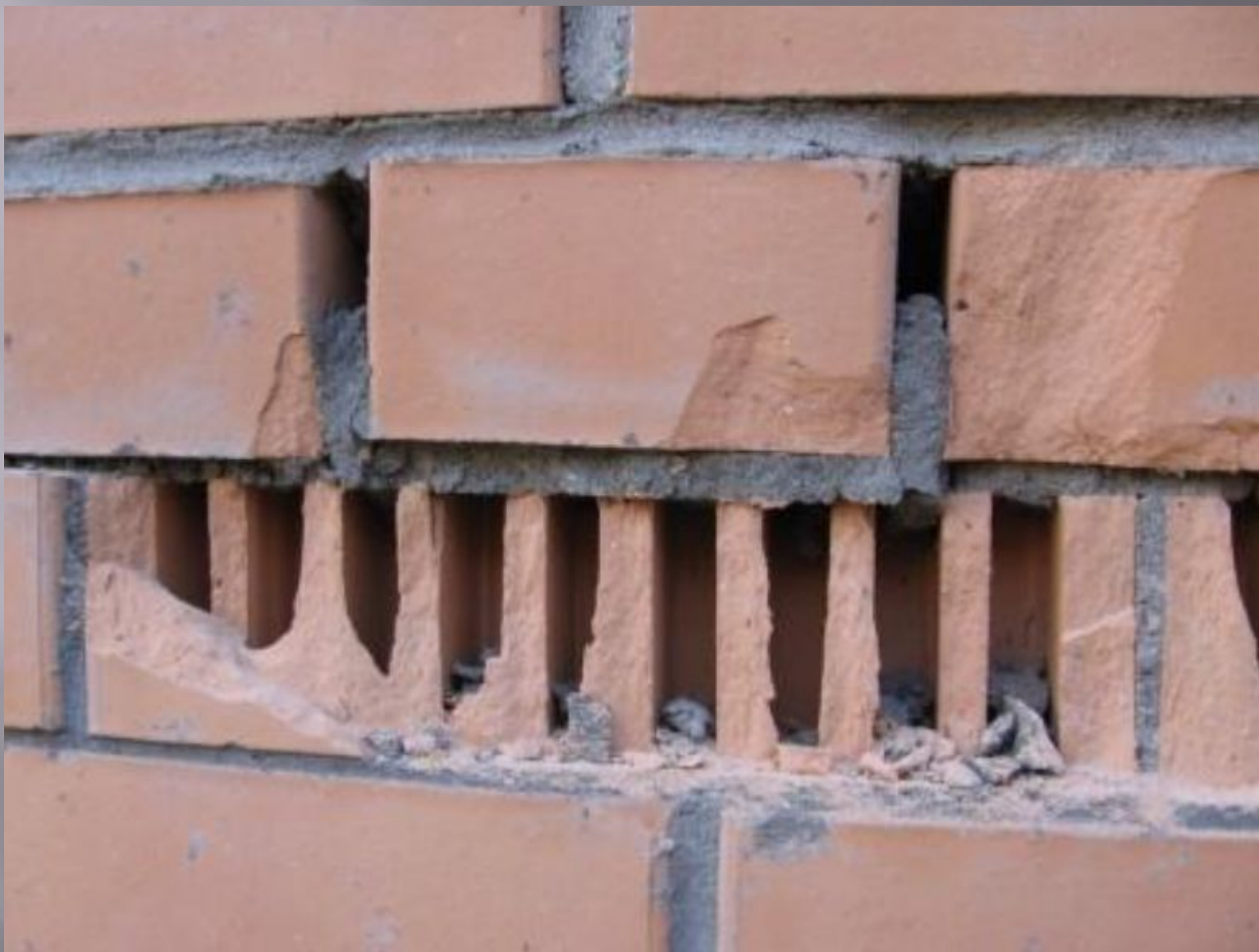
Разрушение отдельных кирпичей в кладке с выветриванием раствора
