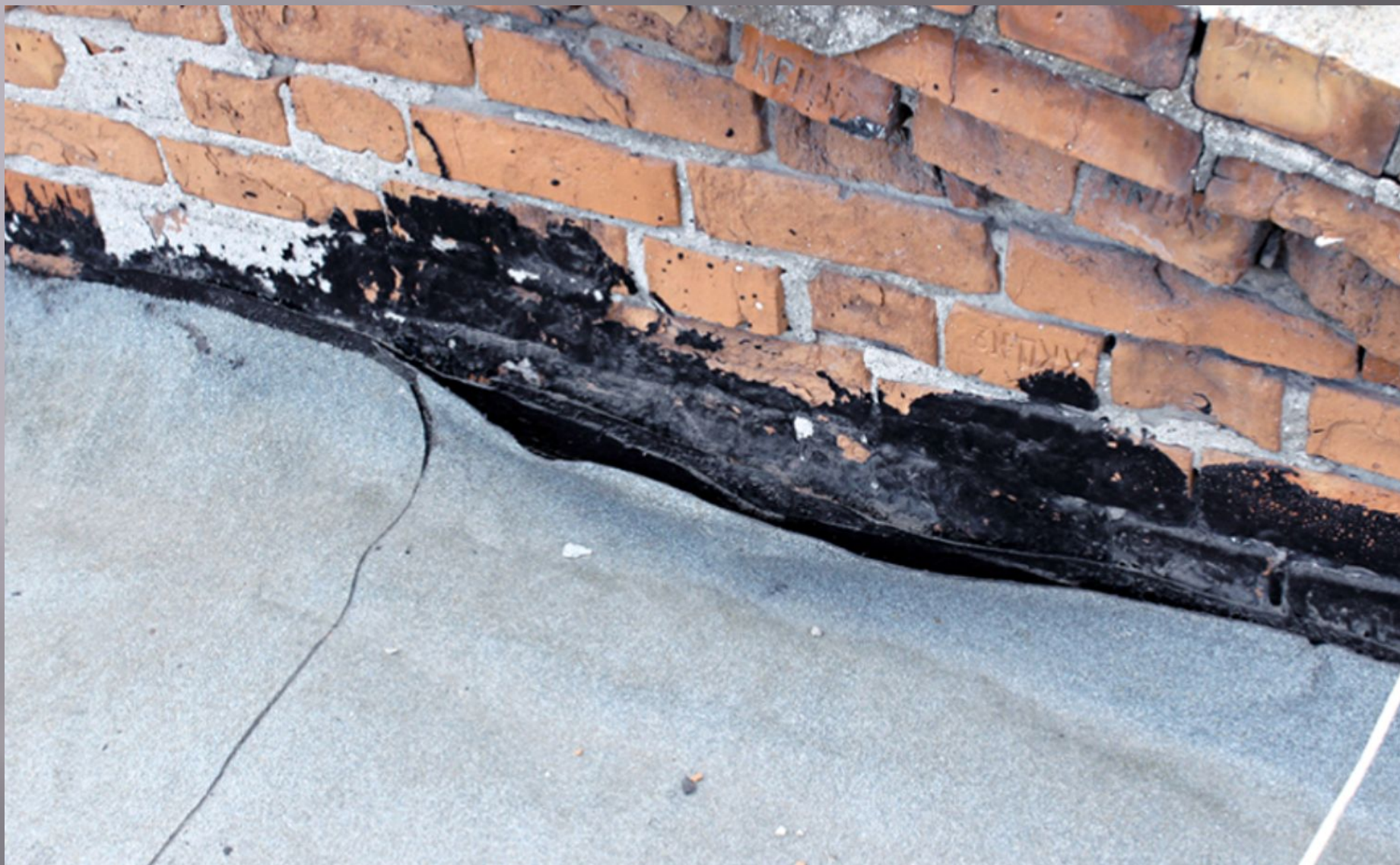
Отсутствие элементов из оцинкованной стали
