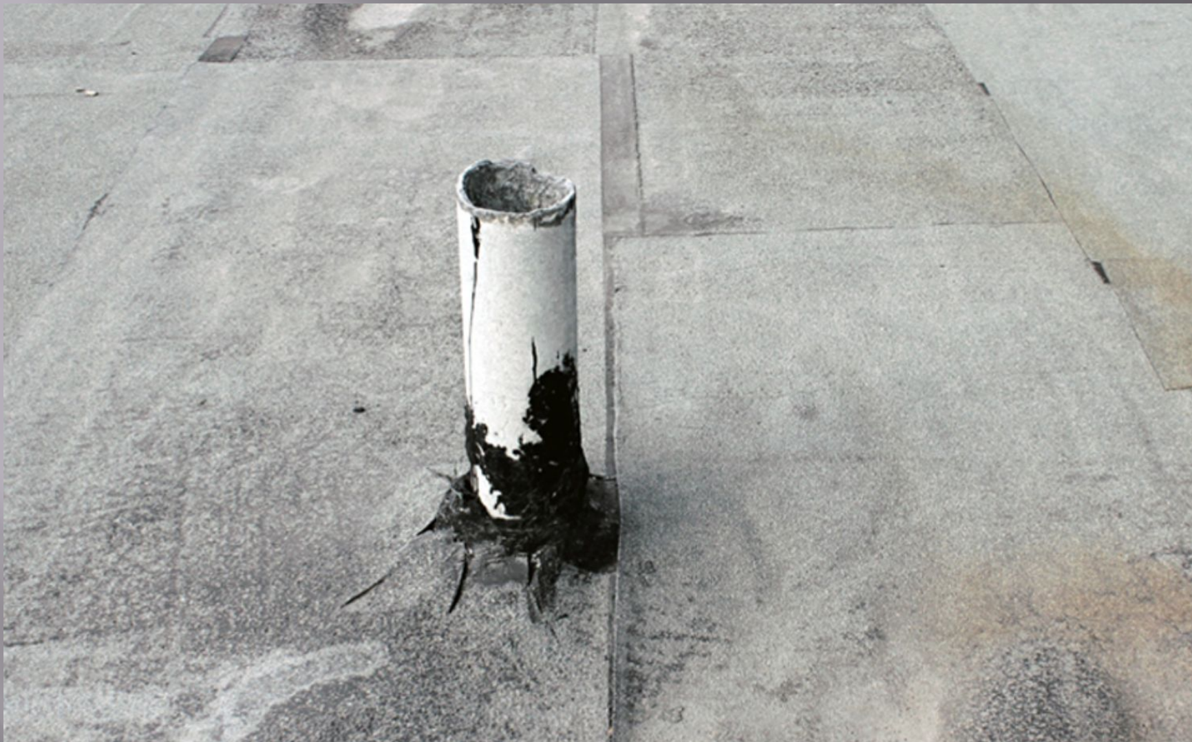
Дефект прочих элементов кровли - отсутствие защитных колпаков на сантехнических вытяжках
