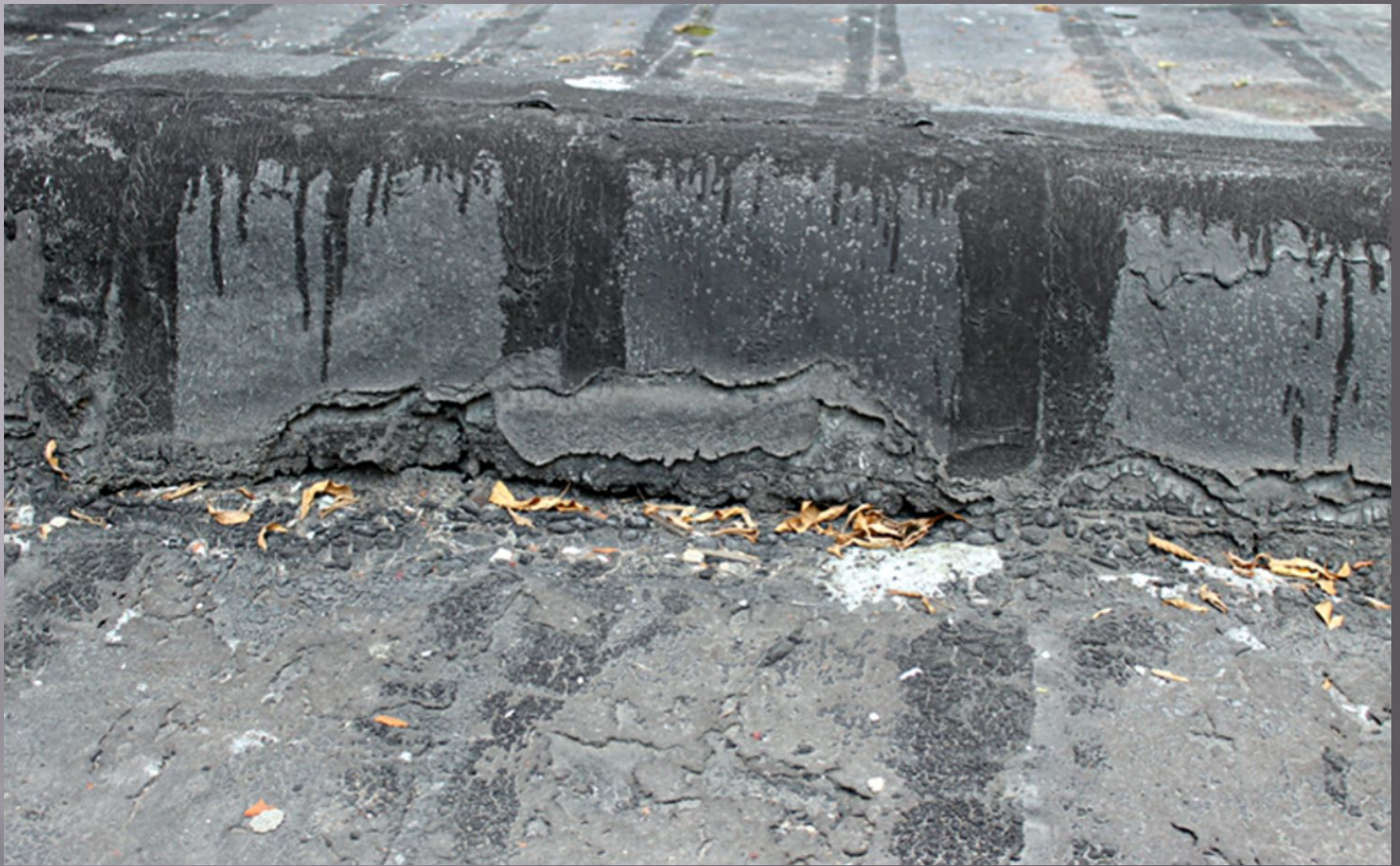
Дефект примыкания к вертикальным поверхностям - механическое повреждение поверхности кровли
