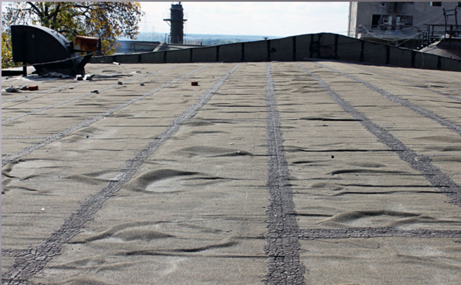
Дефект рядовой кровли - образование вздутий кровельного ковра
