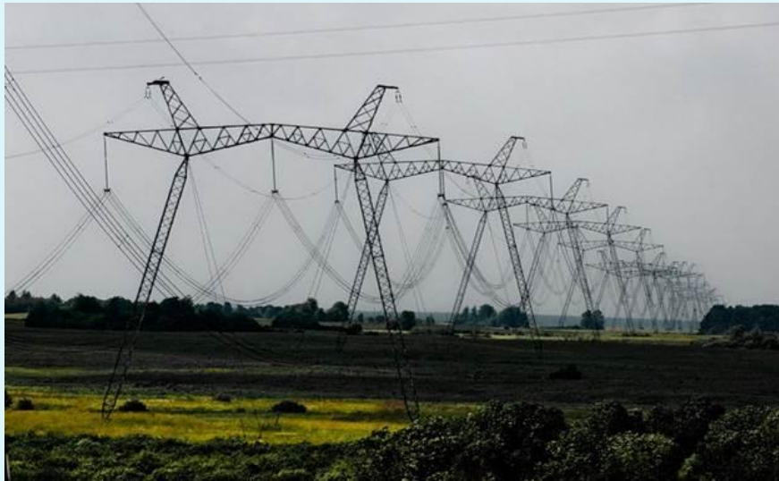
Переменного тока напряжением 750 кВ
