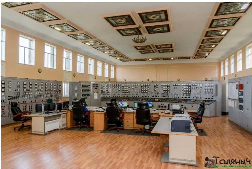
Главный щит управления (ГЩУ) ГРЭС
