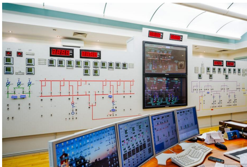
ЦЩУ Бурейской ГЭС
