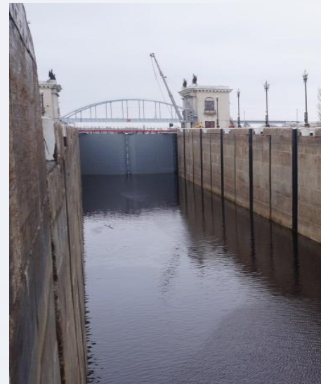
Гидроприводы механизации шлюзов
