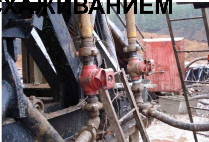
Вид нижней части двух тампонажных стояков высокого давления
