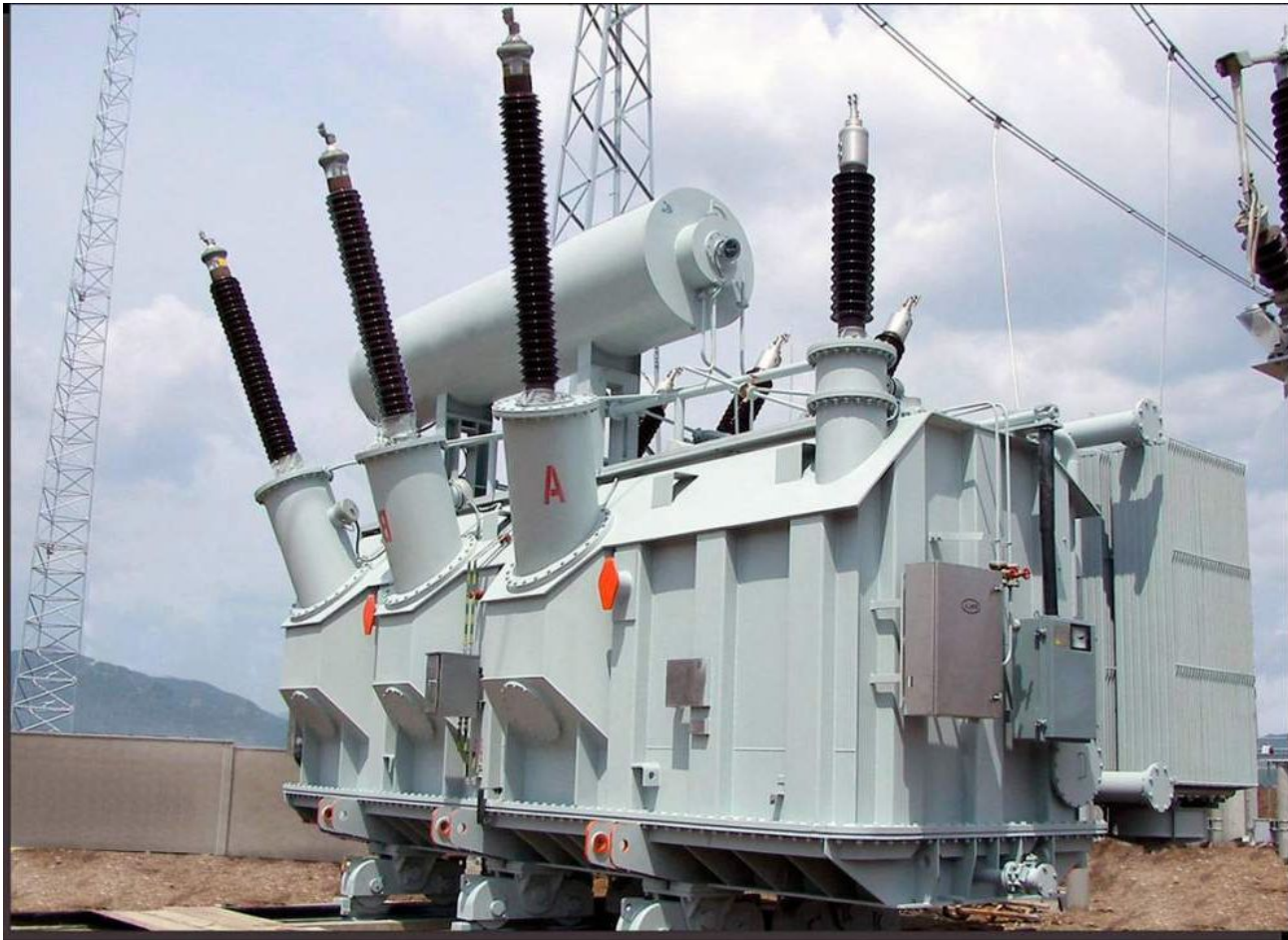
Силовой трансформатор 220 кВ
