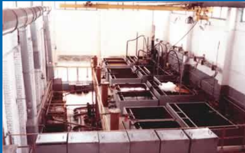
•Станция нейтрализации сточных вод
