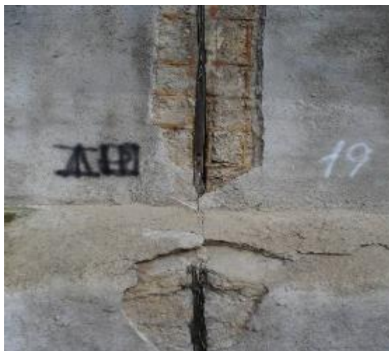
Вид деформационного шва разделительной стенки до ремонта
